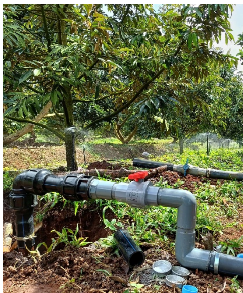
Hình 4. Thực trạng hệ thống tưới.
