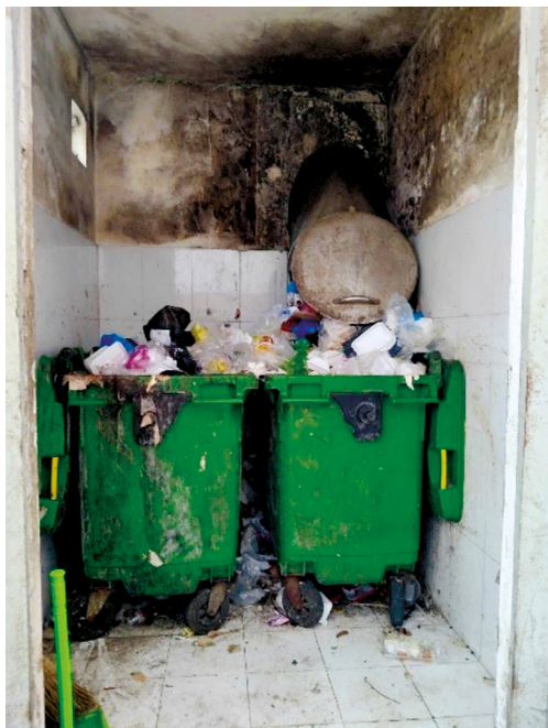
Hình 2. Đường ống dẫn rác tích tụ rác thải.
